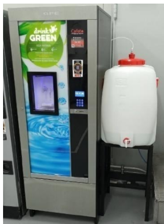
Dipòsit recollida d'aigua de la màquines d'osmosi
